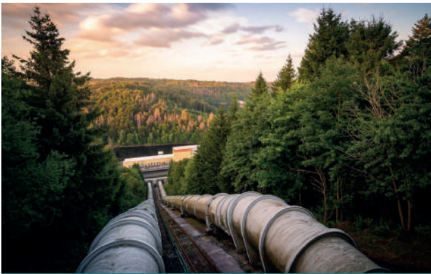
Conduites forcées d'une centrale hydroélectrique
